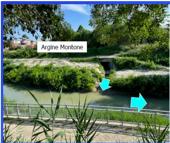
Fig. 7- Un piccolo affluente in sponda sx costituisce una evidente via potenziale di rigurgito se non dotato di valvola clapet (“di non ritorno”) o protetto a sua volta da argini dietro l'argine del fiume principale, in questo caso il Montone (Forlì, 2023).
