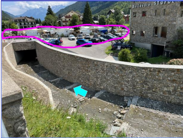
Fig. 6- Una sistemazione recentissima (foto di fine luglio 2023) di un piccolo torrente montano con un box culvert, prono a intasamento repentino, una zona di alta affluenza pubblica giusto al di sopra (parcheggio, adibito in certi giorni a mercato pubblico) e presenza di garage sotto il livello dell'alveo (a dx), sebbene per ora protetto dal muro arginale (Aprica, SO).
